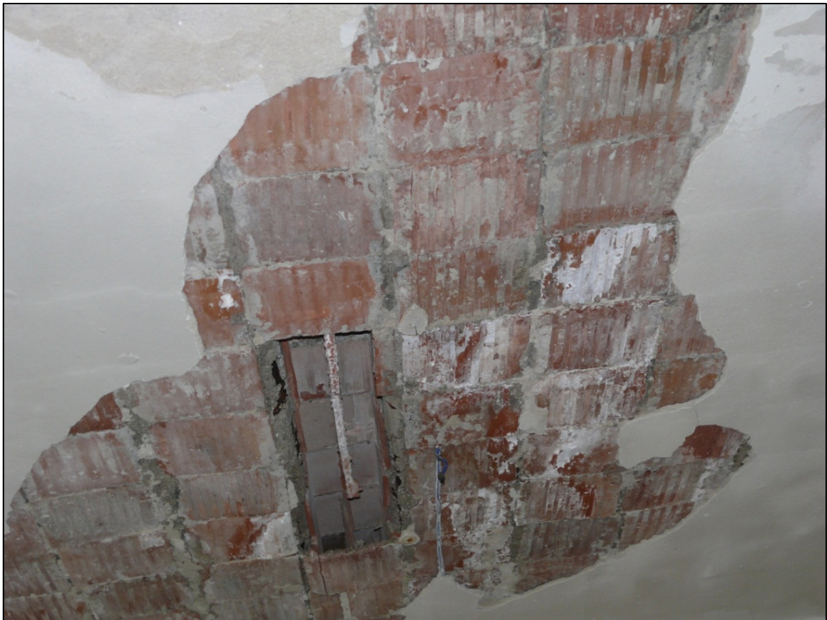
Uszkodzony strop nad piętrzem w segmencie N
