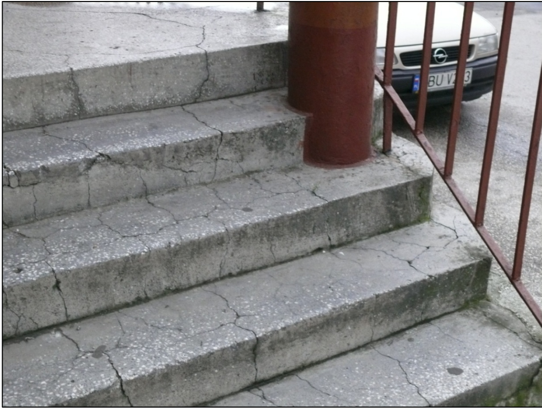
Zniszczone schody wejściowe do łącznika
