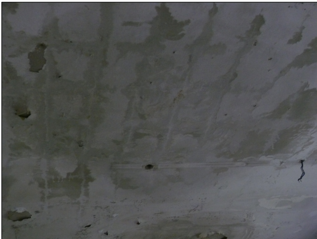
Zawilgocony strop w segmencie N
