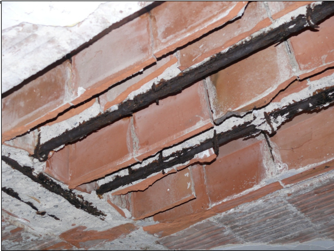
Uszkodzony strop nad piętrem w segmencie N
