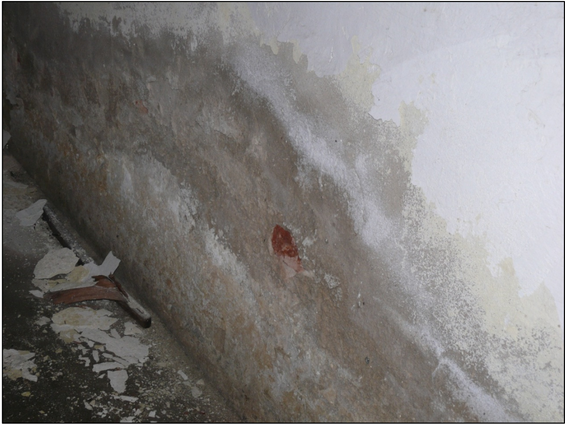
Zawilgocone ściany w segmencie N
