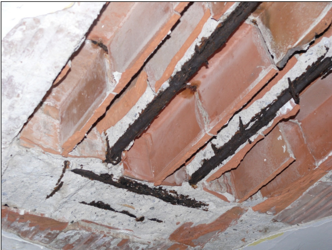
Uszkodzony strop nad piętrem w segmencie N
