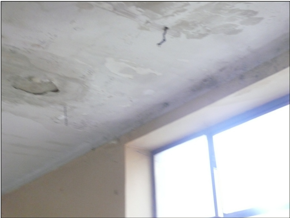
Zawilgocenie i odpadanie tynku stropu nad piętrem w segmencie N
