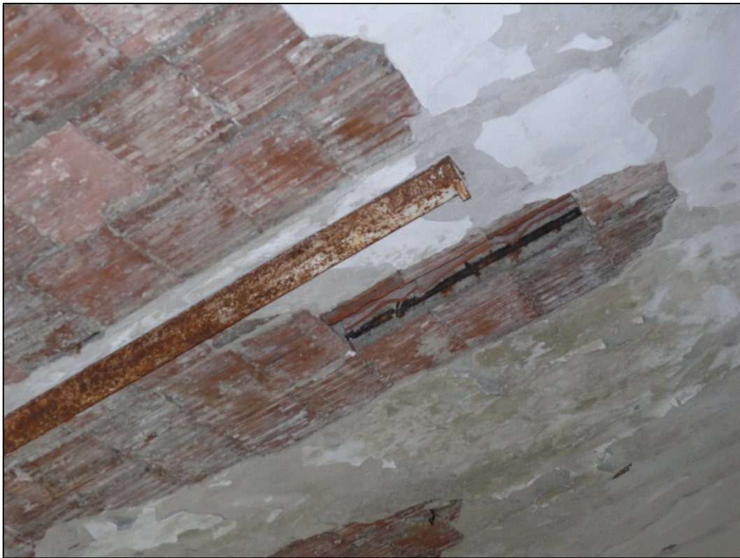
Uszkodzony strop nad piętro w segmencie N
