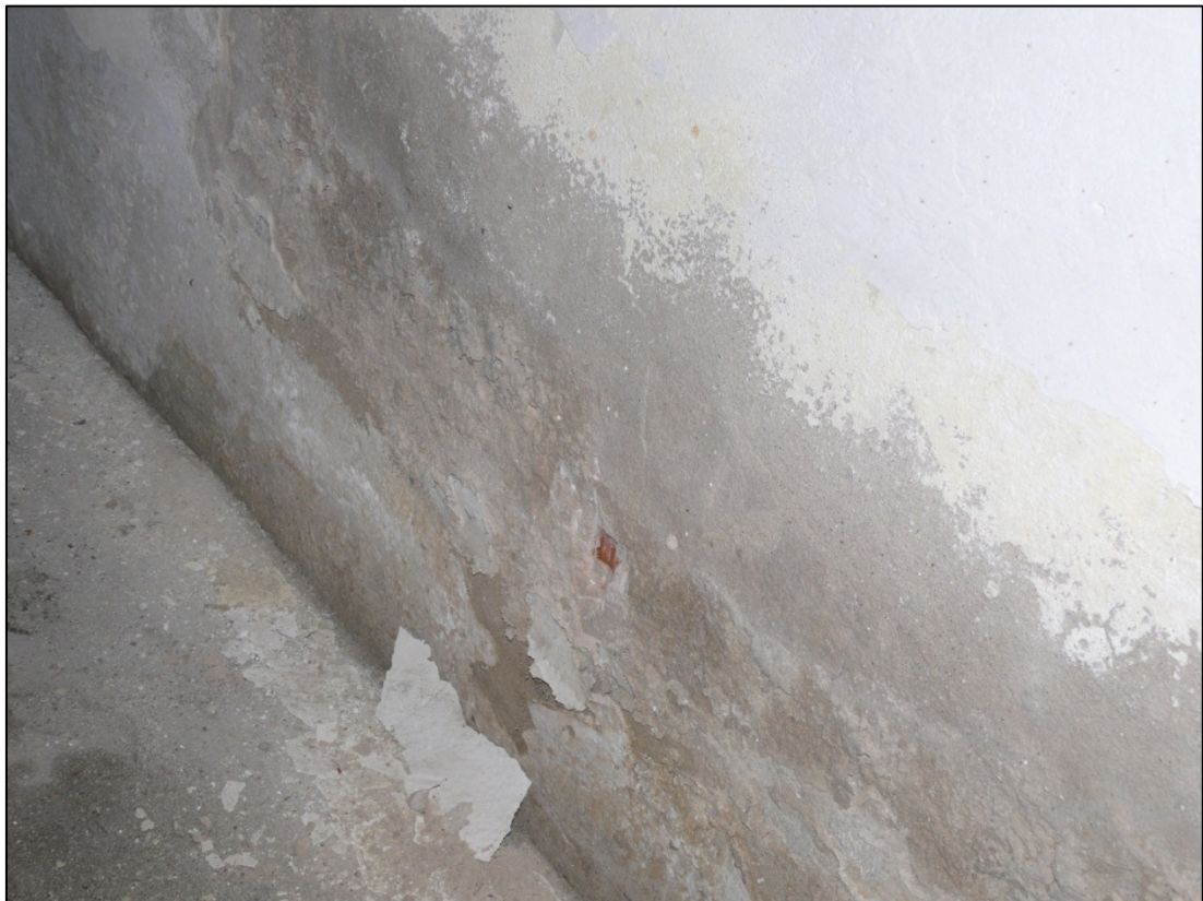
Zawilgocone ściany w segmencie N
