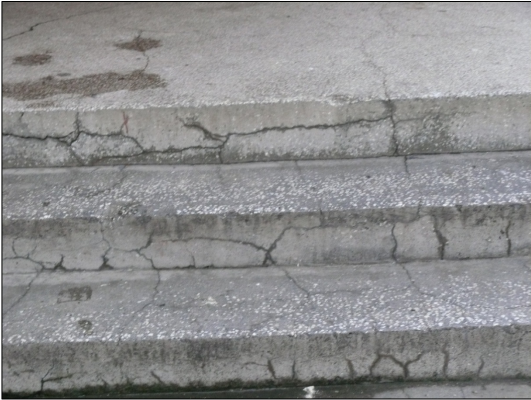
Zniszczone schody wejściowe do łącznika
