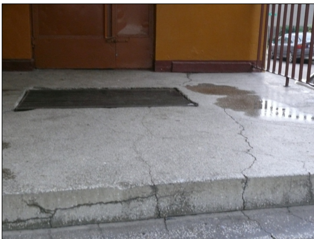
Zniszczone schody wejściowe do łącznika
