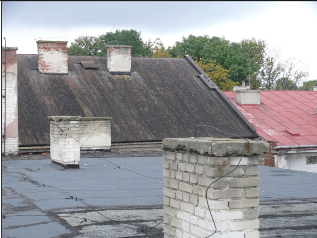
Uszkodzone kominy nad dachem
